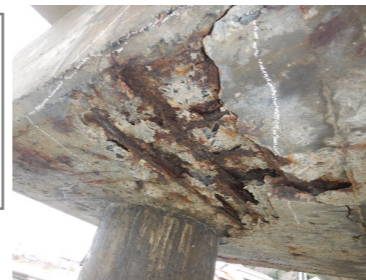
コンクリートの鉄筋露出
