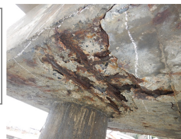
コンクリートの鉄筋露出
