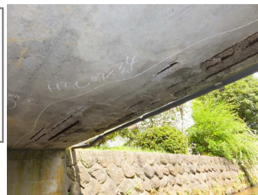
コンクリートの鉄筋露出
