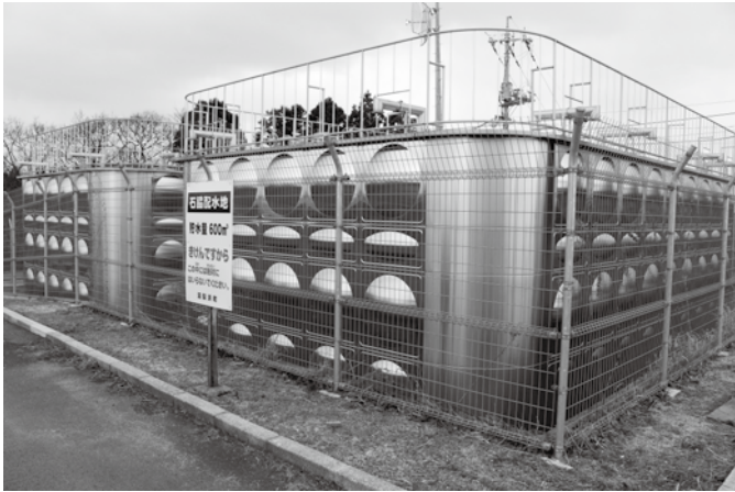
安心・安全な水を供給（石脇配水池）
