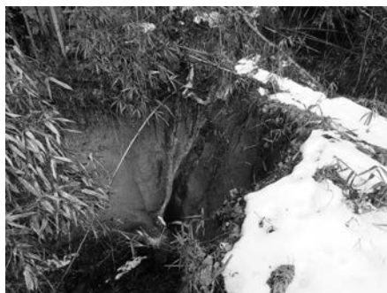
流出水で浸食された堤体（漆原）
