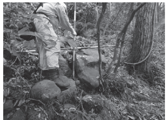
急がれる落石対策（羽衣石地区） 写真提供：中部総合事務所
