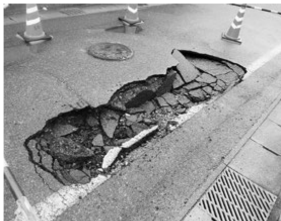
地震で陥没した道路(上浅津)
