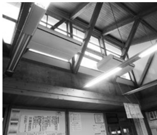
設置されたエアコン(羽合小学校)
