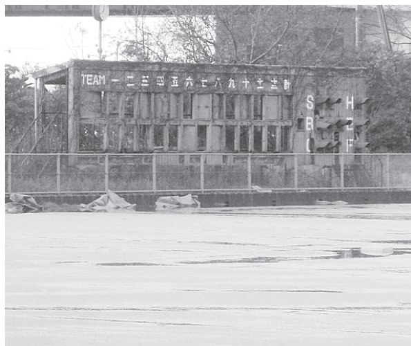
多くの施設維持に膨らむ改修費（羽合野球場）
