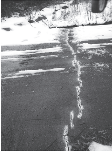
亀裂が進行する筒地原線（筒地）
