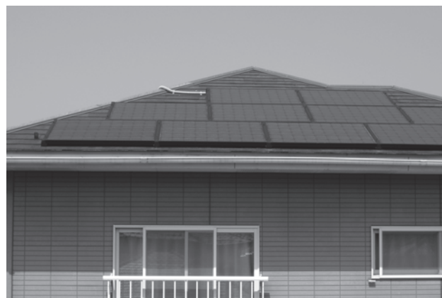
住宅に設置された太陽光発電パネル
