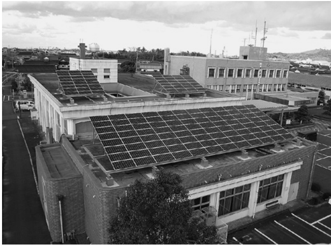
11月に役場屋上に完成した太陽光発電施設
