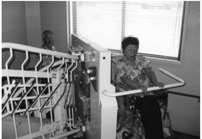
バリアフリー化された庁舎設備（車いす用昇降機）
