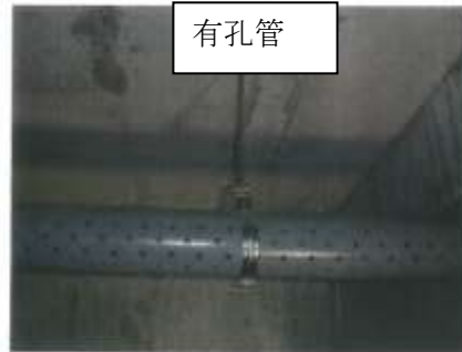
写真② ビット内ガス抜き管
