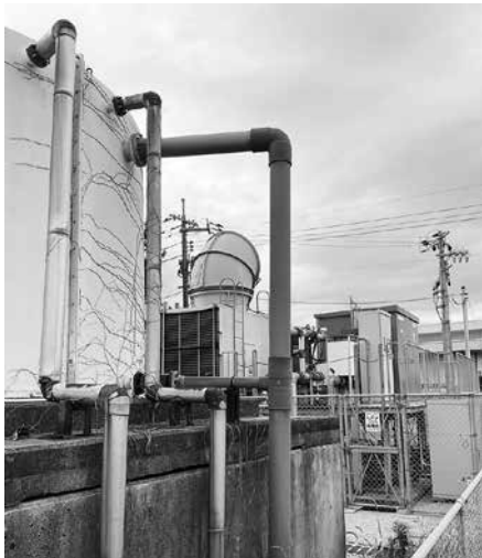
温泉熱をマンゴー栽培に活用 (龍島の温泉熱発電所)
