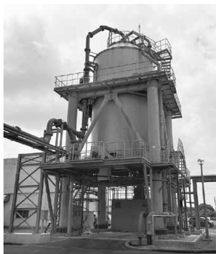
汚泥は堆肥に (天神浄化センター)
