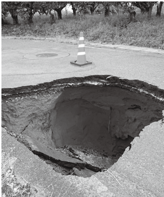
復旧が急がれる陥没現場
