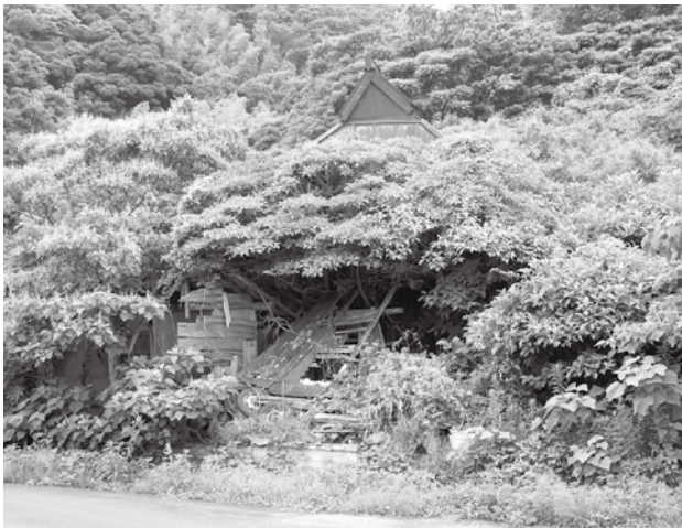
崩れかかった特定空き家
