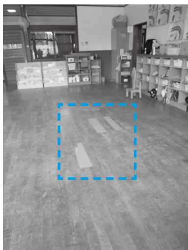
テープで補修された 保育室フロア
