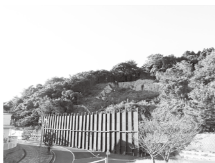
復旧が待たれる町道泊中央線
