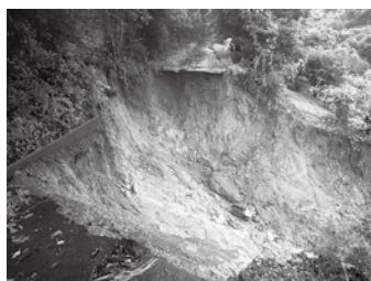
崩落した道路（宇野）
