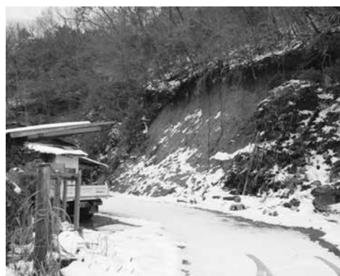
財産区有地から民地への土砂流出 （別所）
