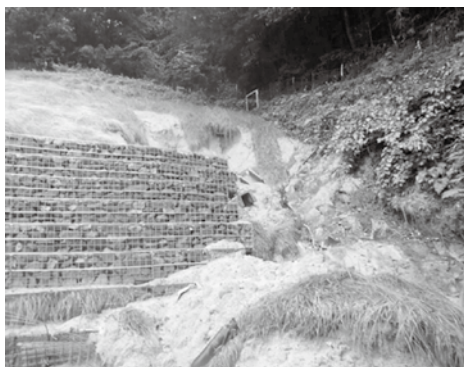
のり面の洗堀状況 (方面)
