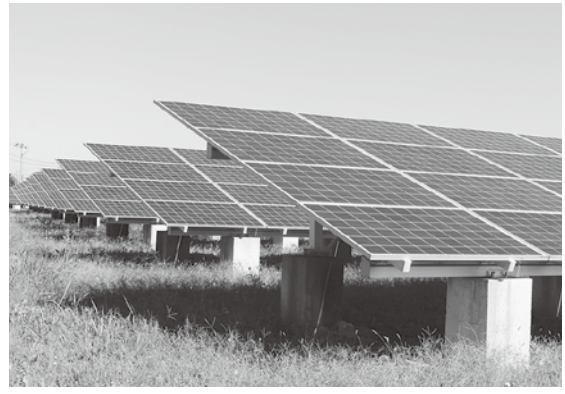
町内設置ソーラーパネル
