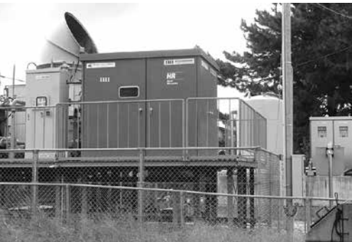
安定した電力供給が可能な温泉熱発電 (龍島)
