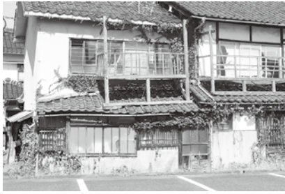
改善が望まれる空き家
