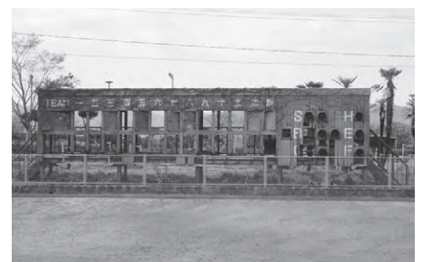
老朽化が著しいスコアボード（羽合野球場）
